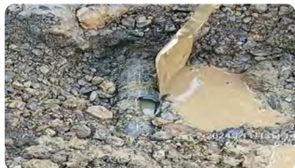
▲ 中管管線鑽損情況
