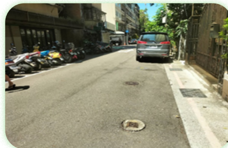
查報瓦斯器箱下陷 - 改善前
