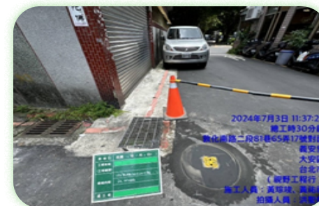
查報瓦斯器箱下陷 - 改善後
