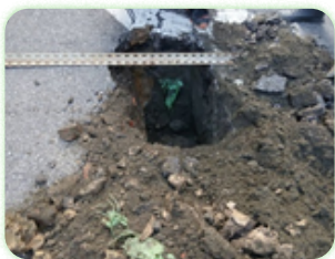
開挖確認造成路面破損 原因交權責單位處理
