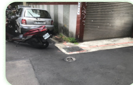
查報瓦斯器箱下陷 - 改善前
