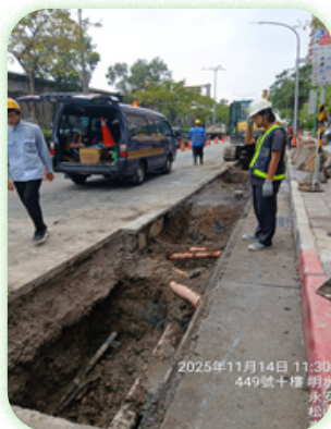
挖損現場檢修人員警戒中
