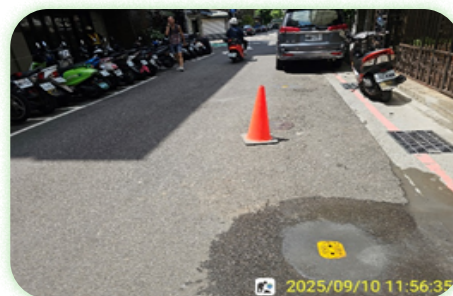
查報瓦斯器箱下陷 - 改善後
