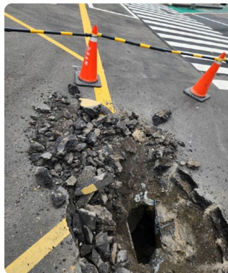
▲ 路面破損，配合新工處現場會勘
