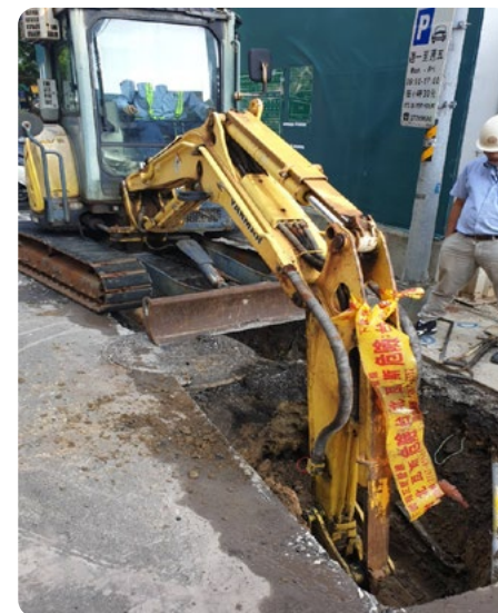
▲ 開挖確認造成路面破損原因交權責單位處理
