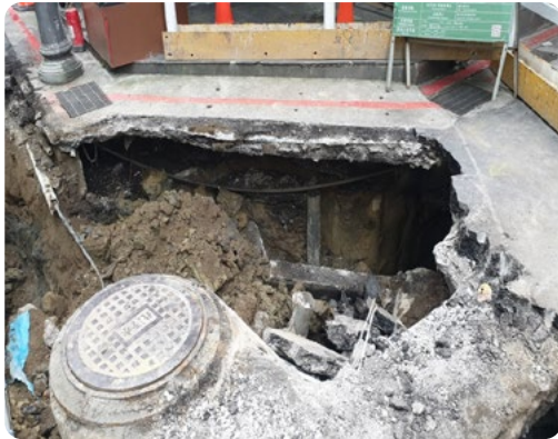
▲ 路基掏空塌陷
