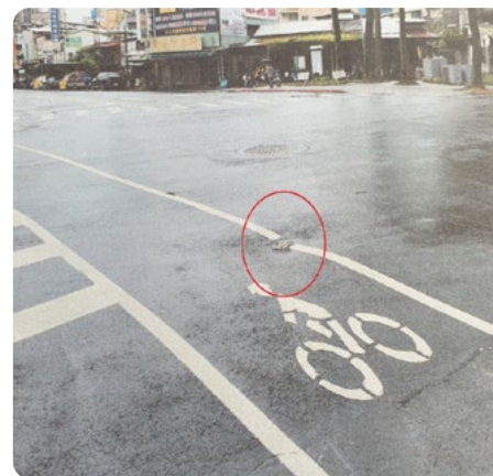
▲ 查報瓦斯器箱下陷 - 改善前
