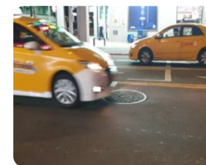
▲ 查報人手孔不平導致汽車壓過產生聲響 - 改善前
