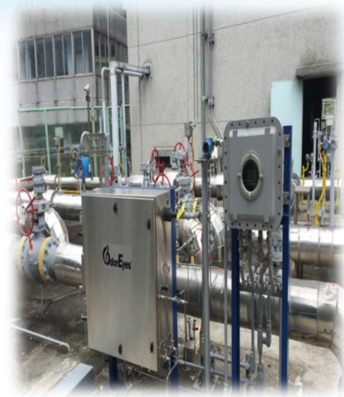
▲ 嗅劑添加設備
