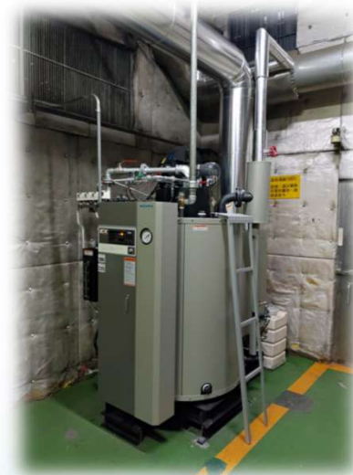
▲ 高效能蒸汽鍋爐
